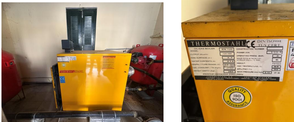
Εικόνα 8: Φωτογραφίες Λέβητα Δημοτικού Σχολείου Βιρού.
